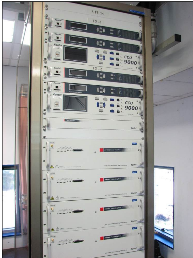
Transmisor 1,7 kWrms ISDB-T/Tb (Serie WHET) Refrigerado por líquido ARGENTINA. 2015
